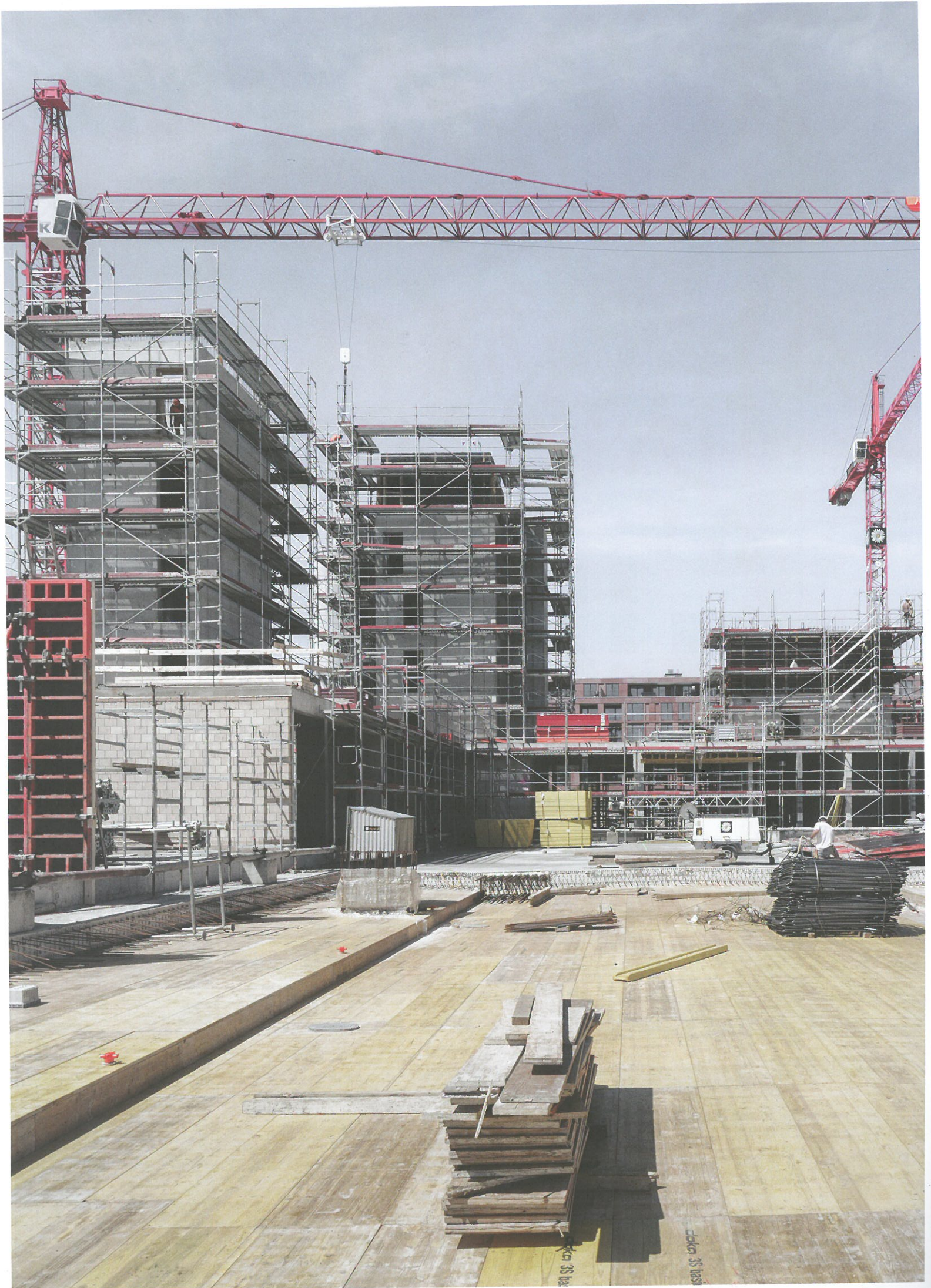
Vorfabrizierter Wohnungsbau: Nach dem Betonieren des Erdgeschosses und der Treppenhäuser dauerte die Montage der Holzbauelemente pro Etappe nur rund einen Monat.
